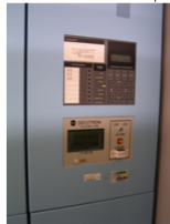
消防安全設備
